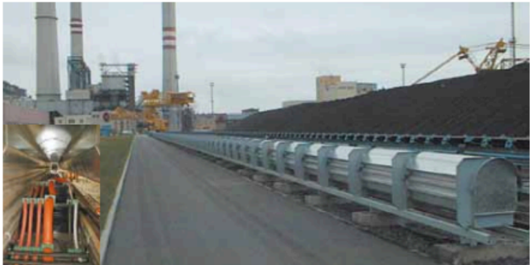
Czech Republik. BBP in CEZ a.s. Power plant supply for dredger excavator in a coal dump. Tschechien. CEZ a.s. Baukastensystem zur Energieversorgung eines Kohle-Baggers.
