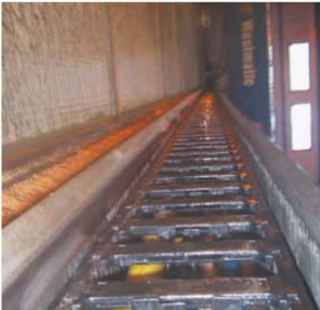
Norway: e.chain® with chainflex® in Truck washing facility. Fine road-dust and gravel/mud. igus® chainflex® cables working well. Norwegen: e.kette® mit chainflex® in einer LKW-Waschanlage. Kommt täglich in Kontakt mit Straßenstaub und Schlamm. chainflex®-Kabel arbeiten hervorragend.
