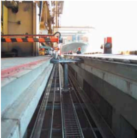
Quay side crane travel equipped with igus® e.chainsystems®. Travels up to 800 m are possible. Kran Kaifahrt mit igus® e.kettensystemen®. Lange Verfahrwege bis 800m sind möglich.
